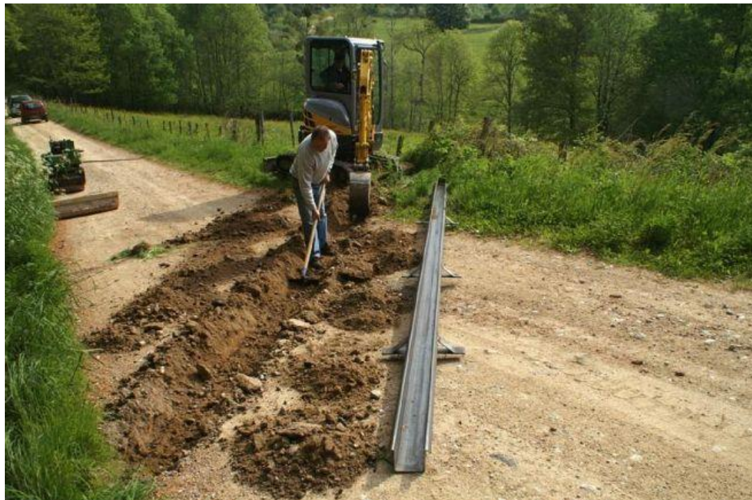
Rigole acier permettant d'évacuer efficacement les eaux de surfaces sur des chemins à forte pente (Sources : journal La Montagne)
